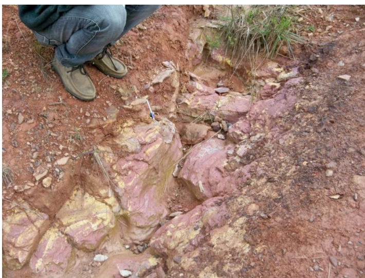
Foto 13 Escoamento de água na lateral da estrada expõe folhelho de coloração castanha avermelhada.
