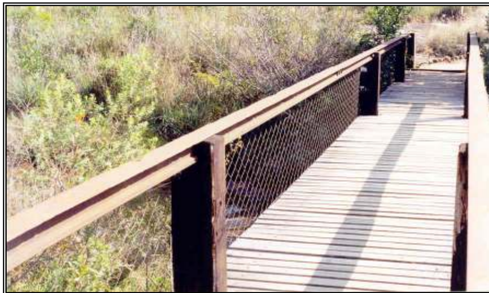
Foto VI.06 - Vista Parcial da Ponte de Acesso ao Centro de Visitantes (fonte: G. Gaertner, 2002)
