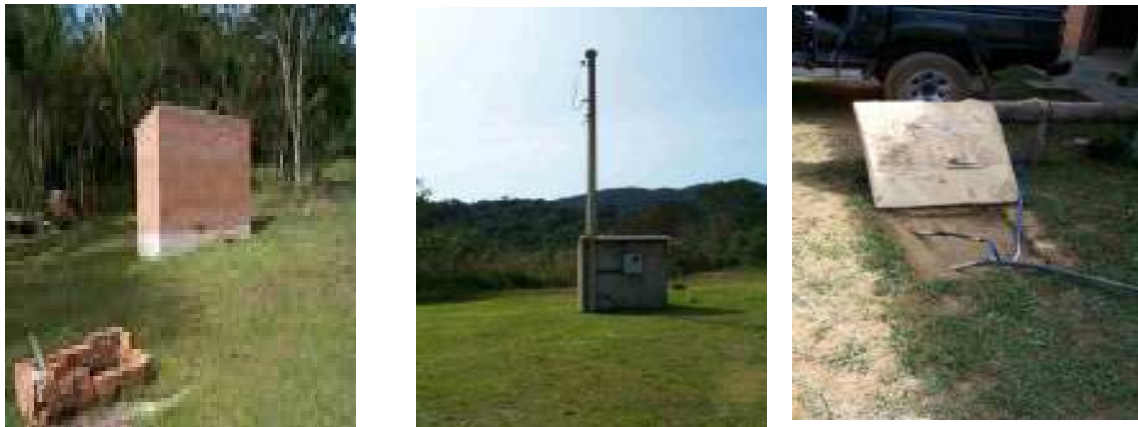
FIGURA 5.7 ESTRUTURAS QUE NECESSITAM DE READEQUAÇÃO
