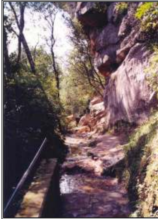
Foto VI.34 - Problemas de Construção e Manutenção na Trilha da Pedra Partida (fonte A. Wandembruck, 2002)
