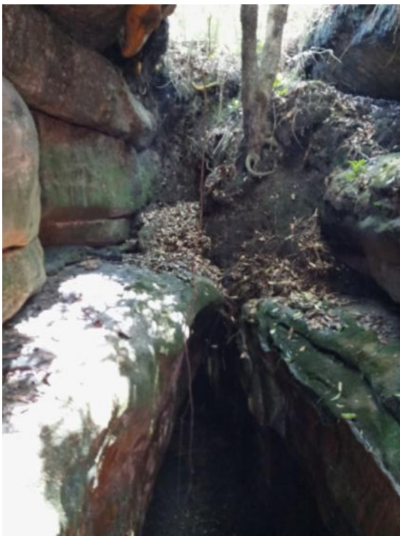
Foto 26: Vista geral das paredes da fenda na direção do desenvolvimento.
