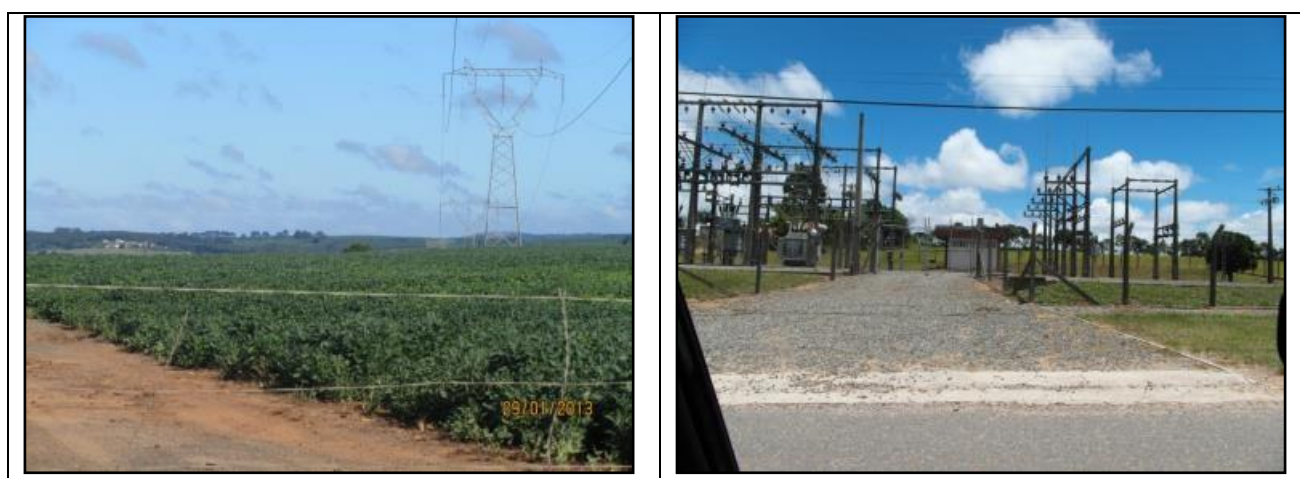
Linha de transmissão que atravessa a Fazenda Boiada e subestação de energia elétrica na Colônia Witmarsun
