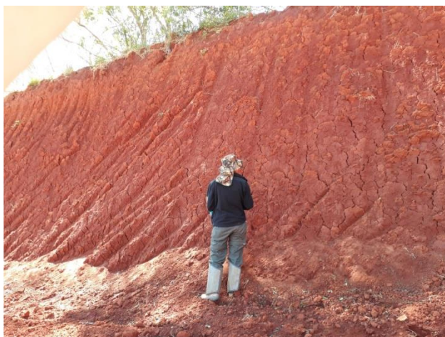
Figura 55: Face N/S do talude de corte; visível os caminhos gerados pelo ressecamento da superfície, e alguns sulcos.
