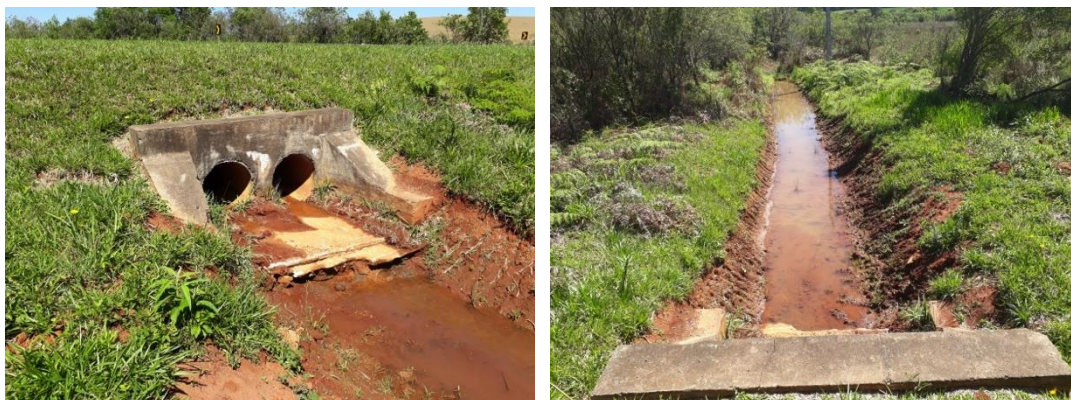
Figura 54: Situação das drenagens do lado oposto da rodovia
