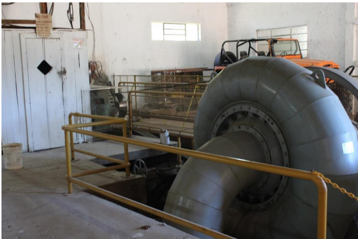
Figura 3: grupo gerador abrigado dentro do galpão de produção
