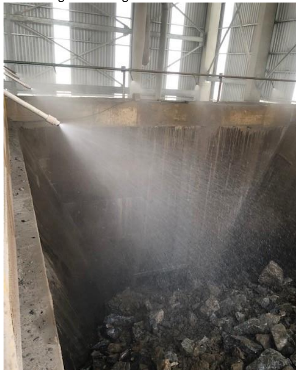
Foto 15 – Sistema de aspersão de água na moega do britador no momento da descarga de um caminhão
