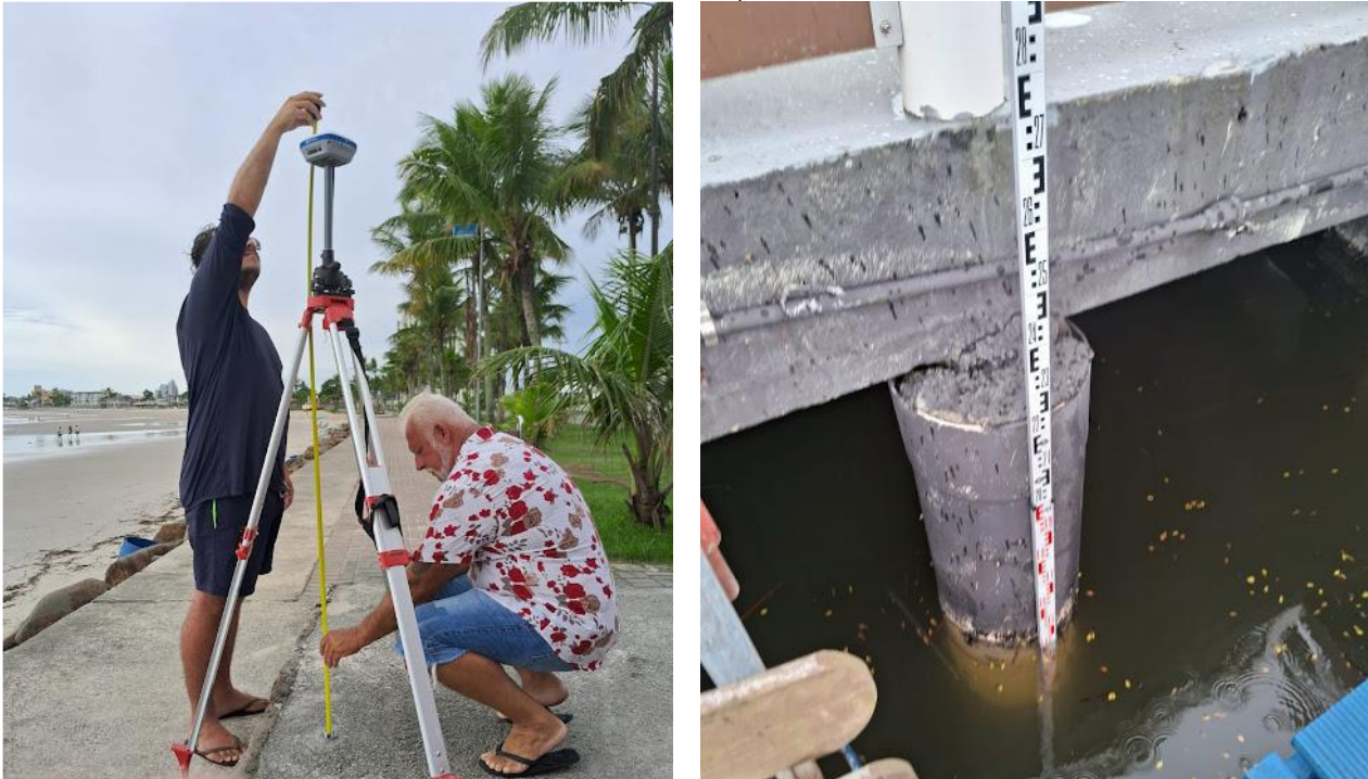
FIGURA 4 – INSTALAÇÃO DA BASE TS02 (ESQUERDA) E INSTALAÇÃO DA RÉGUA DE MAREGRAFIA (DIREITA).
