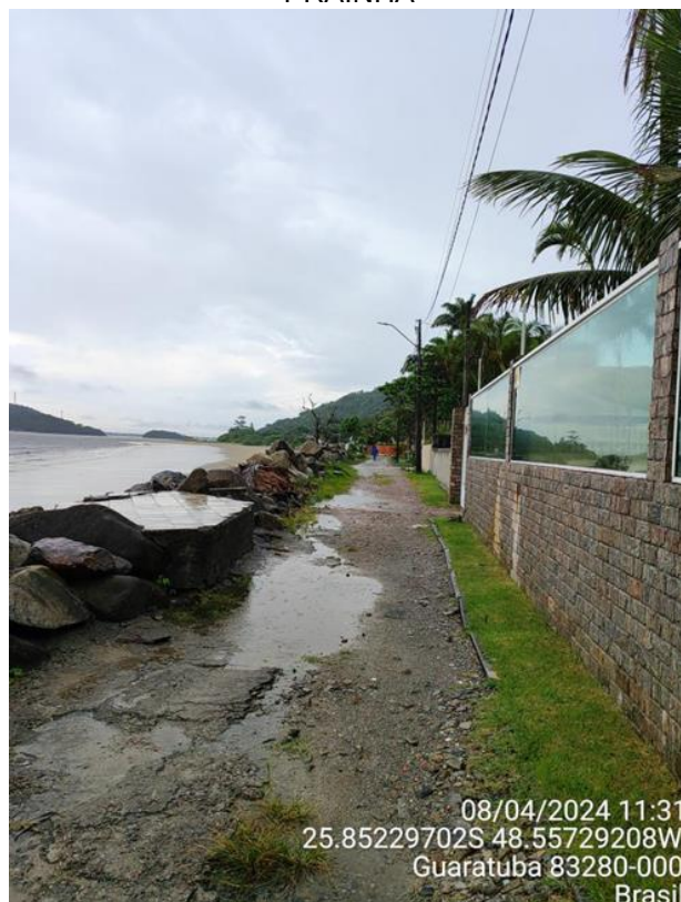
FIGURA 15 – LOCAL COM PROBLEMA DE ESCOAMENTO DA ÁGUA DA CHUVA NA ÁREA DA PRAINHA
