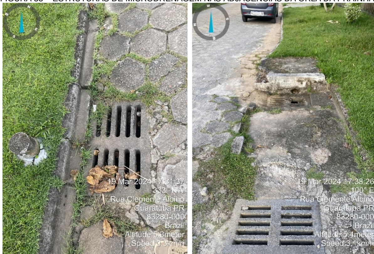
FIGURA 35 – ESTRUTURAS DE MICRODRENAGEM NAS ADJACÊNCIAS DA ORLA DA PRAINHA
