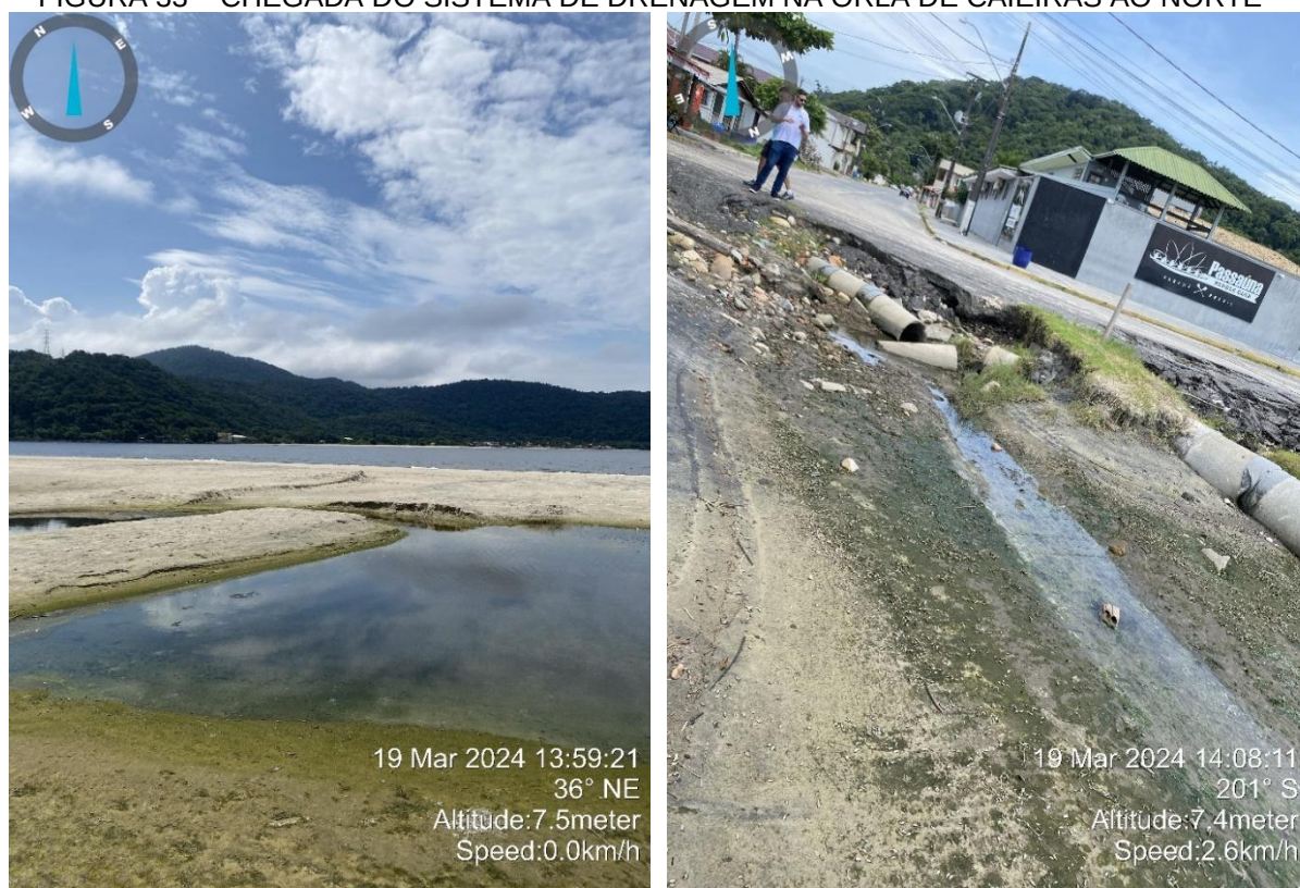
FIGURA 33 – CHEGADA DO SISTEMA DE DRENAGEM NA ORLA DE CAIEIRAS AO NORTE
