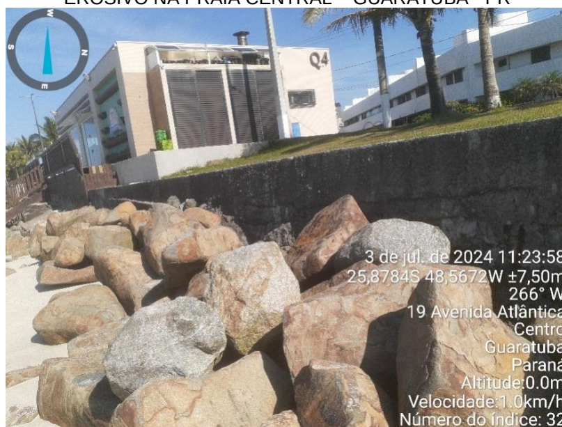
FIGURA 1 – BLOCOS ROCHOSOS UTILIZADOS PARA TENTAR CONTER O PROCESSO EROSIVO NA PRAIA CENTRAL – GUARATUBA - PR
