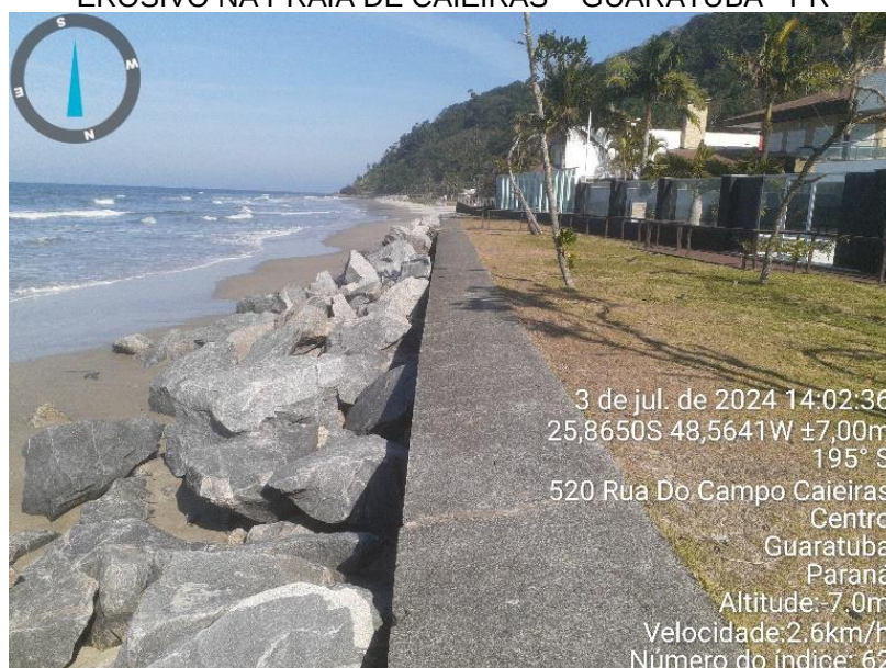
FIGURA 2 – BLOCOS ROCHOSOS UTILIZADOS PARA TENTAR CONTER O PROCESSO EROSIVO NA PRAIA DE CAIEIRAS – GUARATUBA - PR
